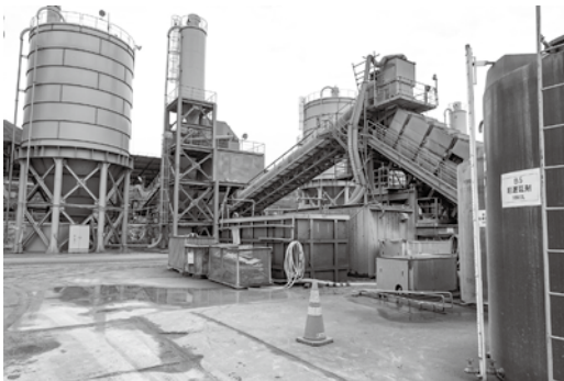
CSG 製造設備
