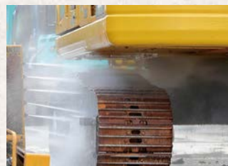
▲ 自動車両洗浄装置
