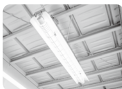
安全増防爆型蛍光灯(室内)
