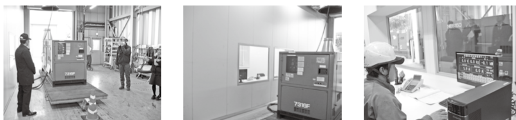
発電機の負荷試験の様子
