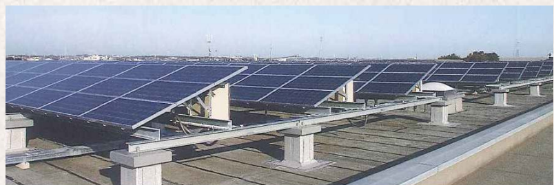
▲工場の屋根に設置された太陽光パネル群
