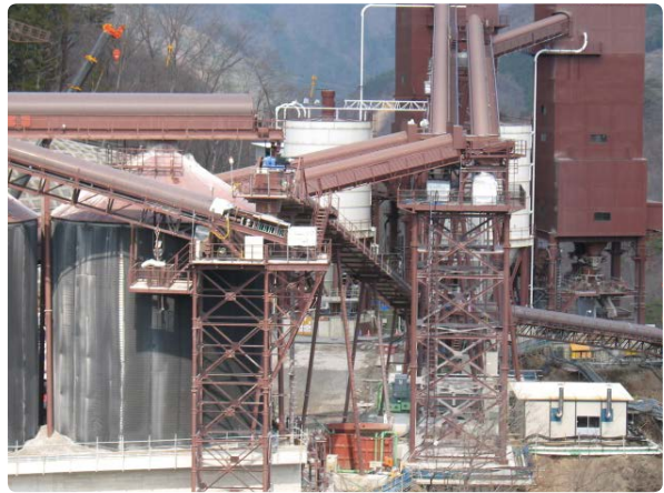
コンクリートプラント
