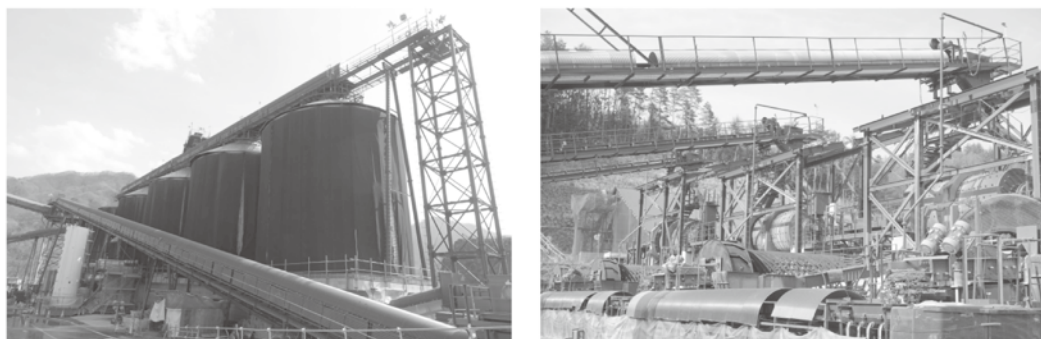
設備をこげ茶色に塗装して野生動物の刺激を緩和する配慮がなされています
