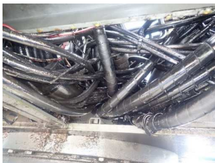
機械下部配管ホース状況
